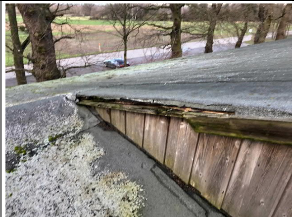
Sanierungsbedürftige Windfeder (IG Liethhalle 2020)
