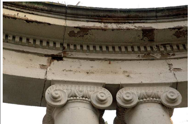
Sanierungsbedarf an der Säulenanlage
