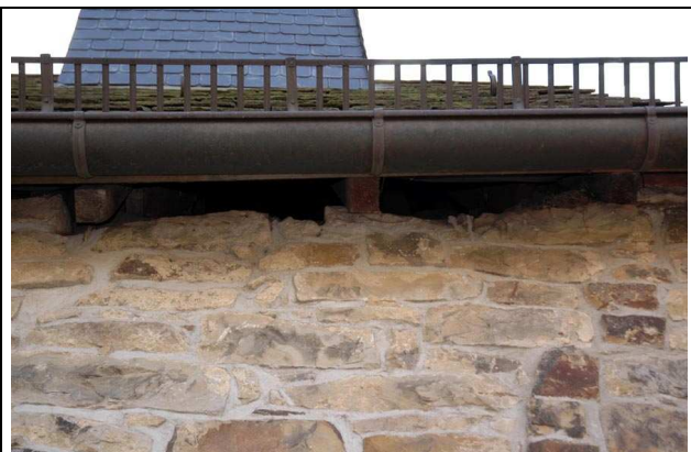
Öffnung zwischen Wand (Nordseite) und Dachstuhl
