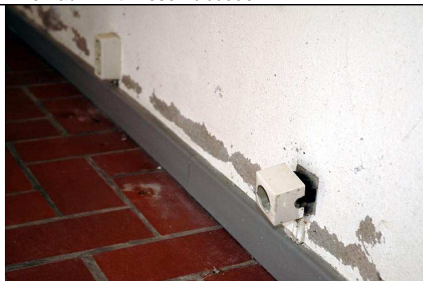
Schäden an Putz und Leitungen
