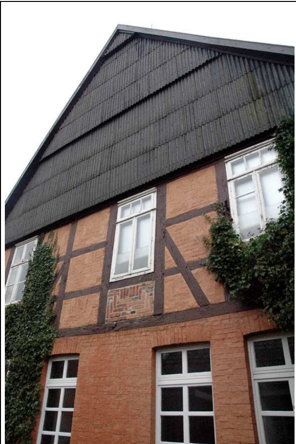
Westseite des Wohnhauses mit den sanierungsbedürftigen Fenstern im Obergeschoss
