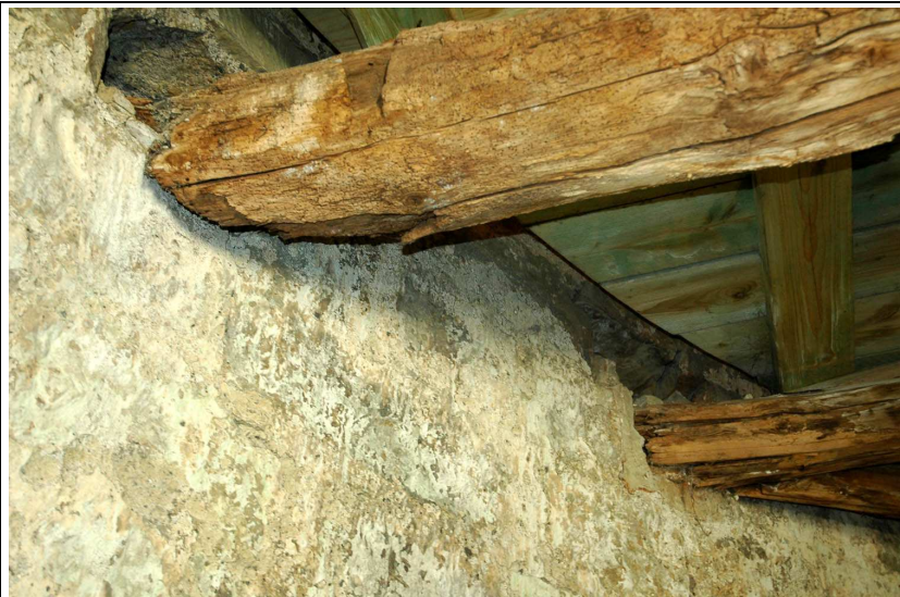
Die Balken der Zwischenböden sind teilweise morsch.
