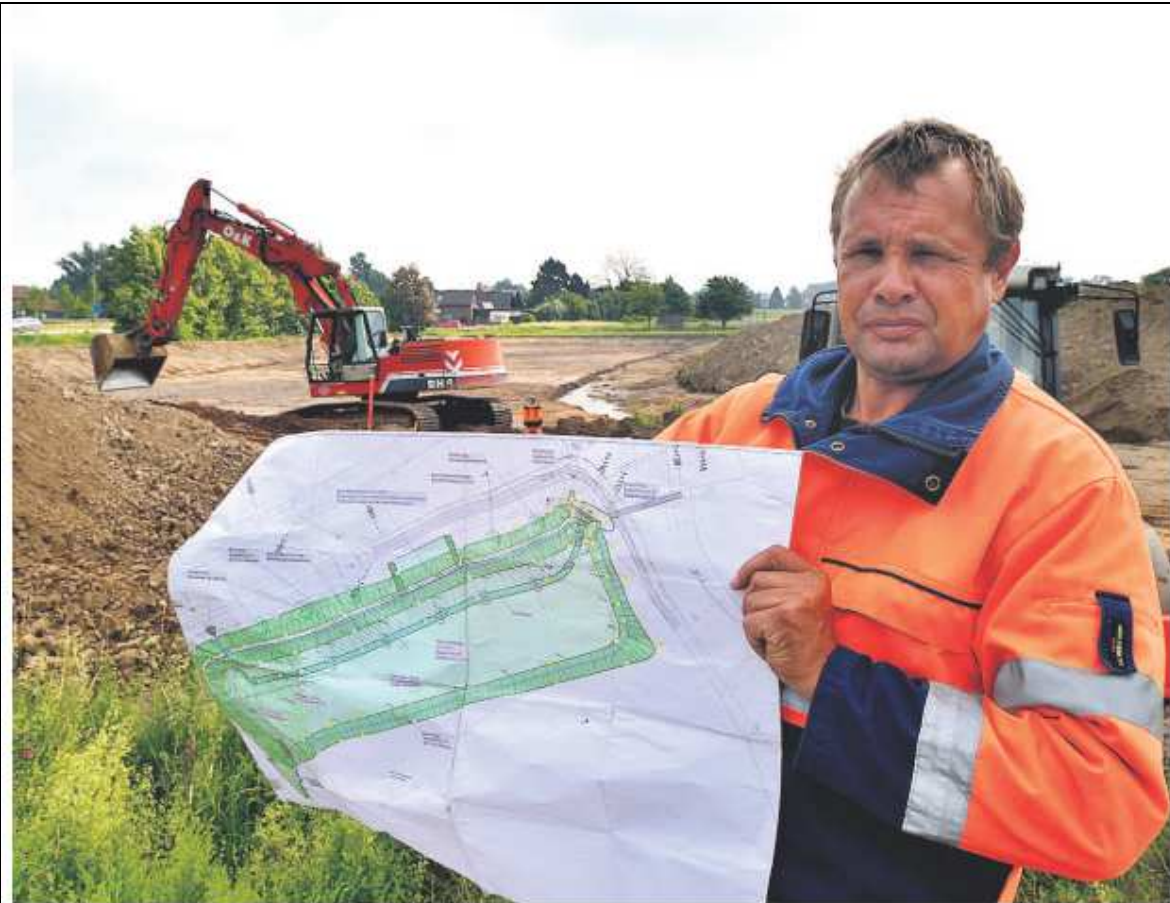
Gerd Nordhorn, Vorarbeiter der Firma Lübckemann, präsentiert den Plan für das neue Regenrückhaltebecken an der B 65 in Gelldorf. Im Hintergrund kauft ein Bagger das Erdreich aus.
